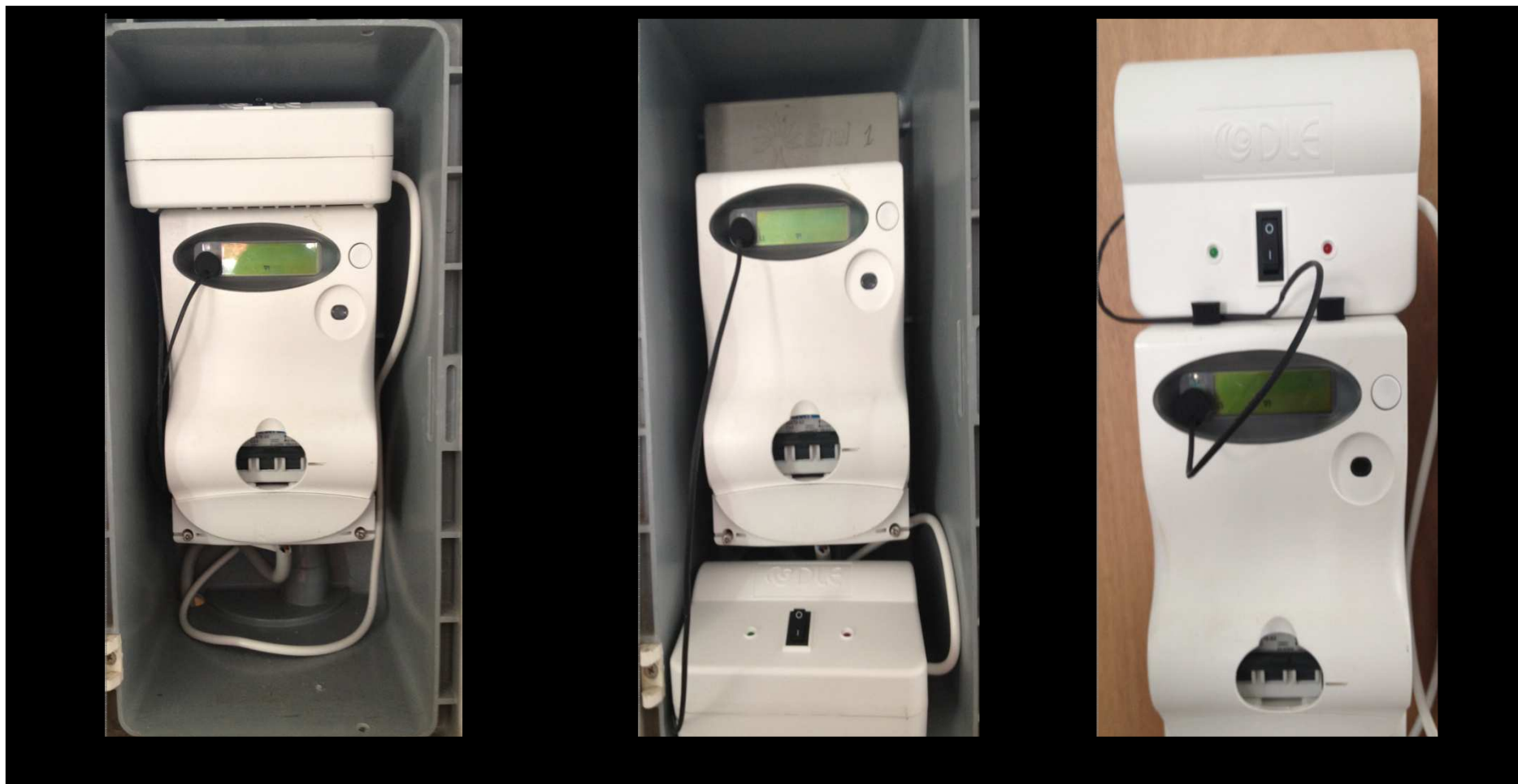
Foto 1 (interno contenitore posizionato in alto)
